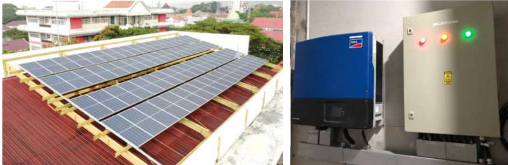
Gambar 6. Konstruksi terpasang sistem panel surya
